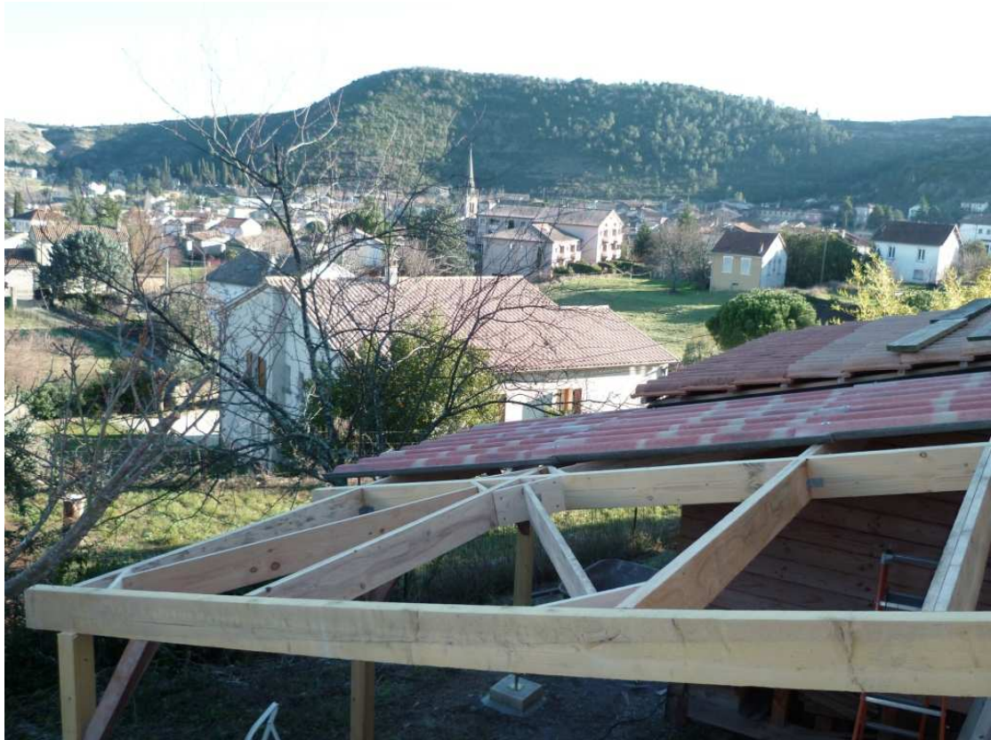
Premier plan : Portée de 4,5m sur bastaing de 6/18cm Arrière plan : le village des Vans, aux pieds du plateau des Gras
